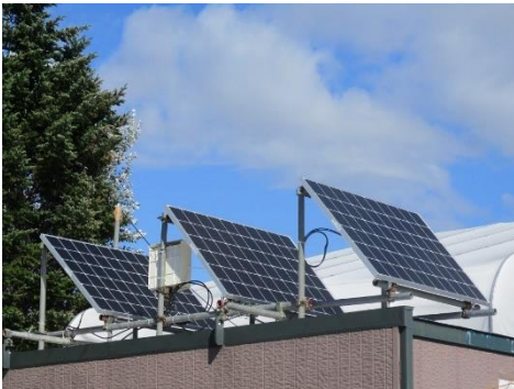
仮設事務所設置型太陽光発電装置 ひまわりⅡ
