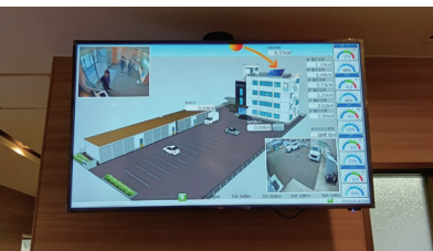
発電量・使用量が一目でわかるモニター
