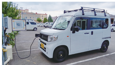
電気自動車 充電設備と併せて導入
