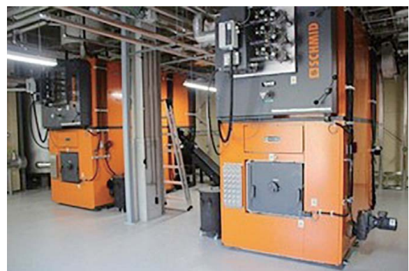
木質バイオマスボイラー
