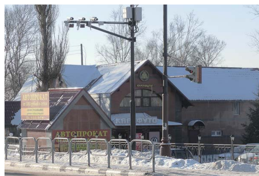
ユジノサハリンスク市内に設置された監視カメラ
