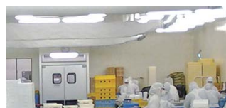
（写真4）空調設備の配管
