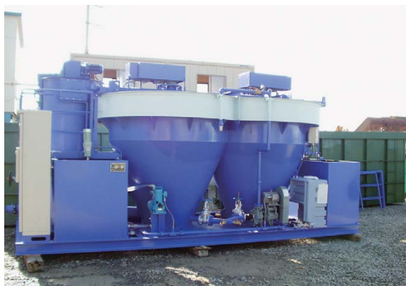
（写真1）「濁水処理装置」 （建設・土木工事等の現場で稼働）
