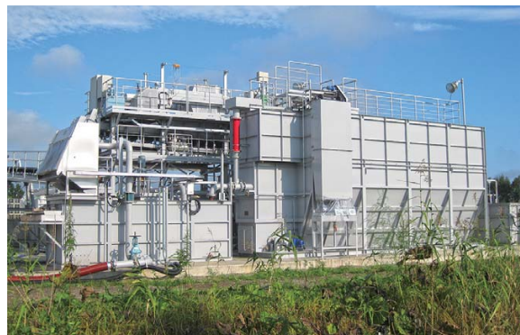
（写真4）「汚泥リサイクル施設」（JAおとふけ） （人参洗浄選別予冷施設から排出される濁水を処理）
